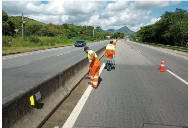
Figura 6.13 Via Lagos – Varrição Barreira de Concreto - Km 14+500 Sul
