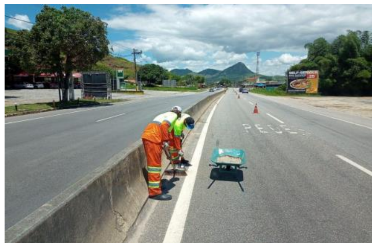
Figura 6.12 Via Lagos – Varrição Barreira de Concreto - Km 13+500 Sul
